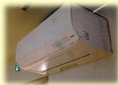
○障害者施設（非営利活動法人） エアコン
